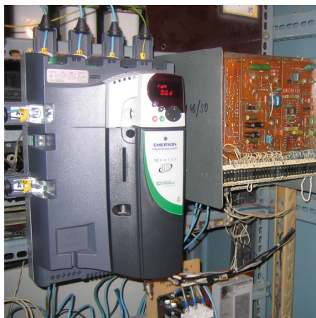
На фото (слева направо) новый привод постоянного тока Mentor MP (Control Techniques) и устаревший привод, произведенный в СССР
